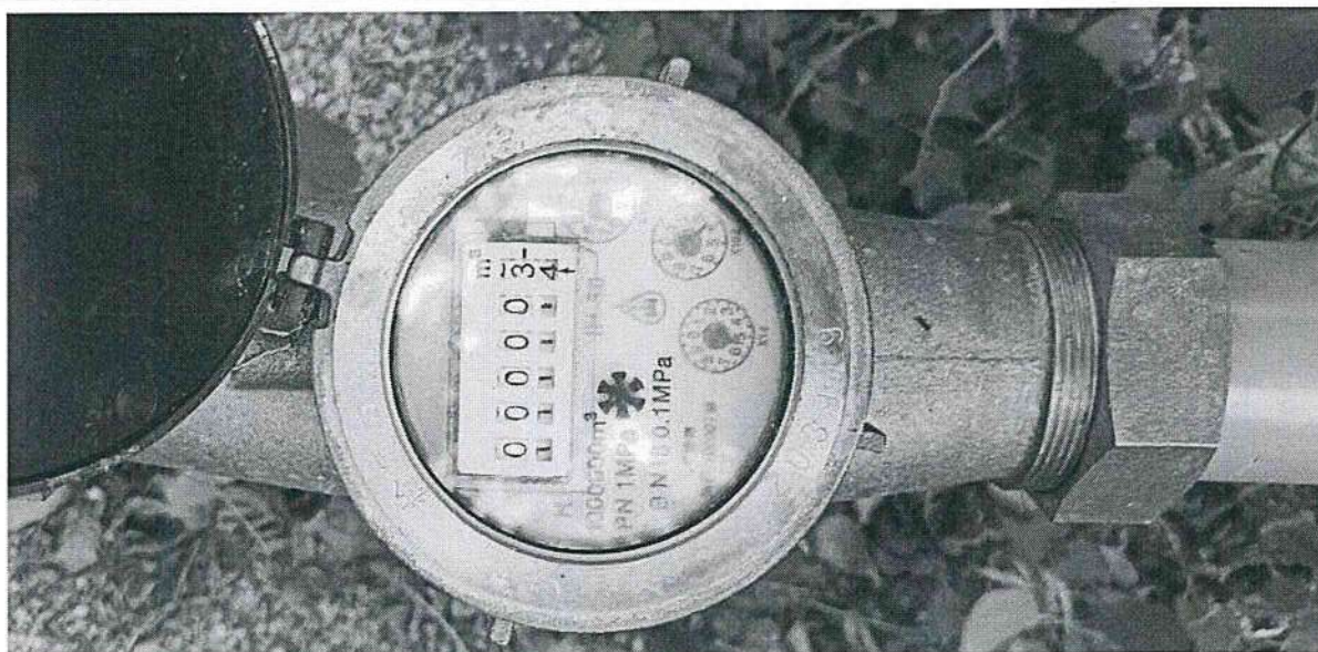
量水設備照片-水錶
