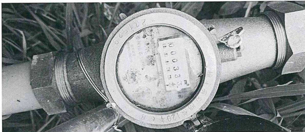
量水設備照片-水錶
