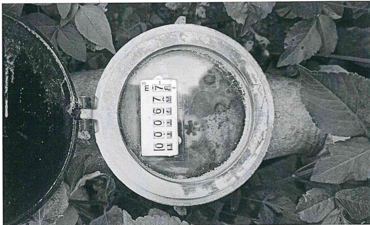
量水設備照片-水錶
