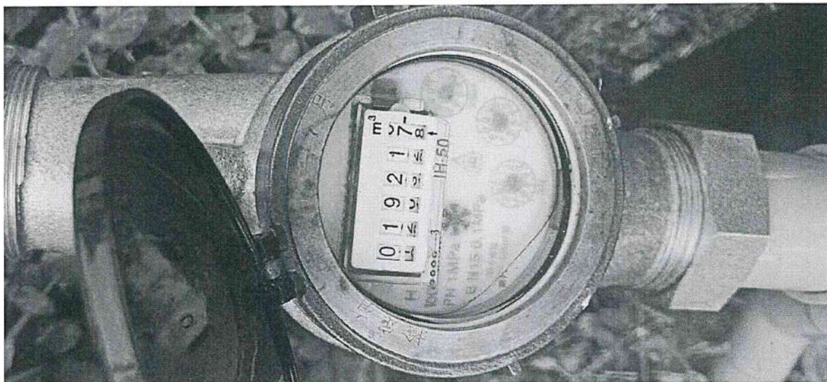
量水設備照片-水錶
